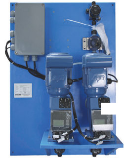
2 EMP III Pumpen eine Dosierleitung, OGM
