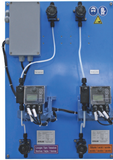
2 EMP II Pumpen, zwei Dosierleitungen
