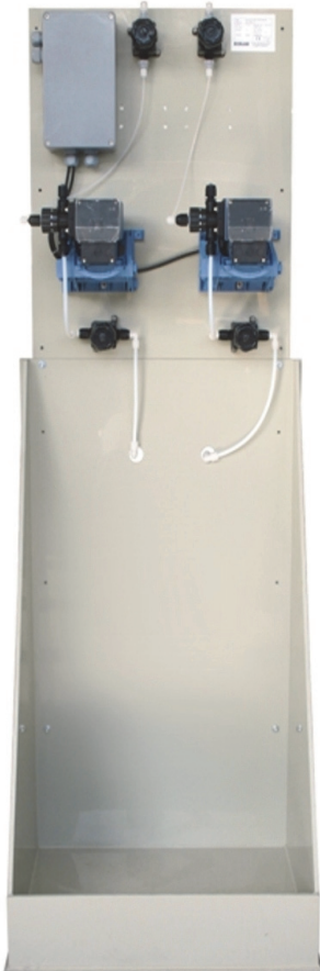
2 EMP KKS Pumpen 2 Dosierleitungen
